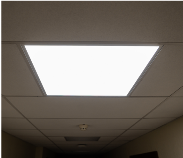
Зображення 12 – Встановлені LED-світильники у будівлі Мінфіну
