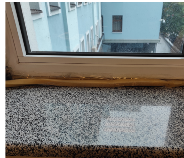
Зображення 24 – Вигляд стану вікон до виконання енергоефективного ремонту
