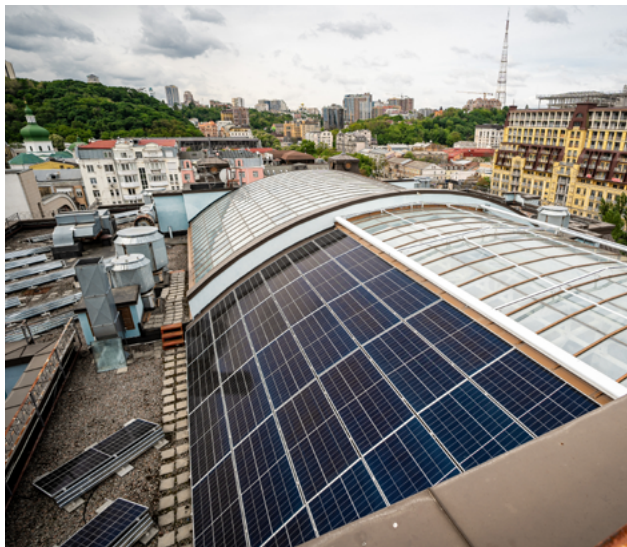
Зображення 27 – Фотоелектричні панелі на будівлі Мінфіну
