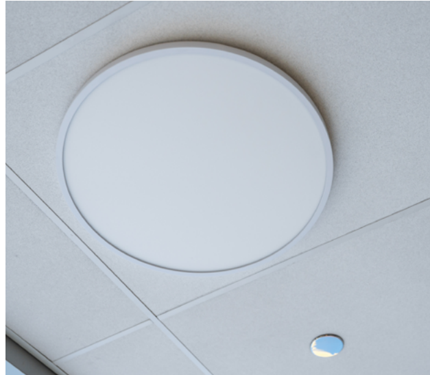
Зображення 13 – Встановлені LED-світильники у будівлі Мінфіну
