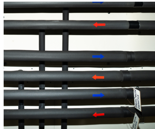
Зображення 6 – Термоізольовані трубопроводи в неопалювальному гаражному приміщенні (підвалі)
