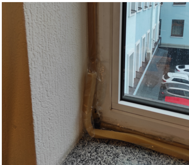
Зображення 23 – Вигляд стану вікон до виконання енергоефективного ремонту
