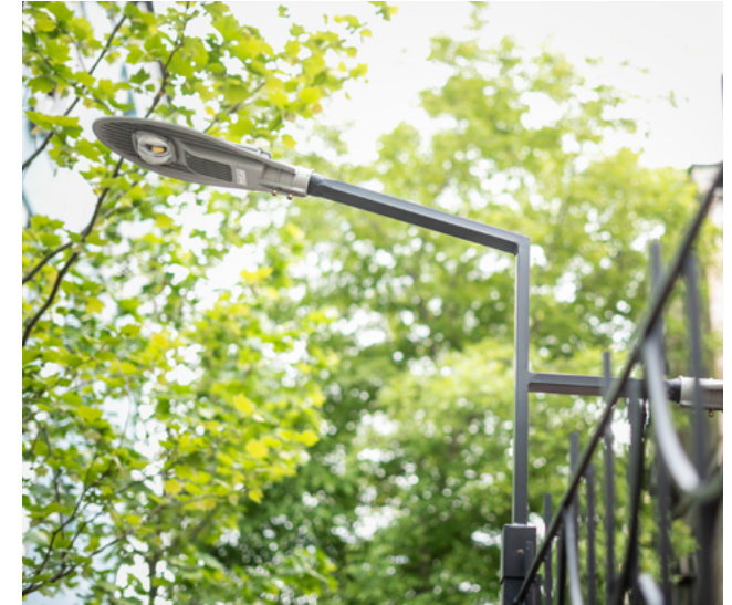
Зображення 14 – Встановлені двонаправлені LED-світильники на огорожі Мінфіну
