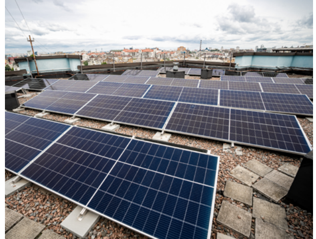
Зображення 6 – Фотоелектричні панелі сонячної електричної станції на покрівлі будівлі Міністерства фінансів України
