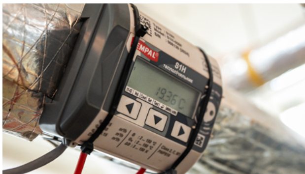
Зображення 9 – Засіб обліку теплової енергії, під'єднаний до автоматизованої системи збору інформації в будівлі Міністерства фінансів України
