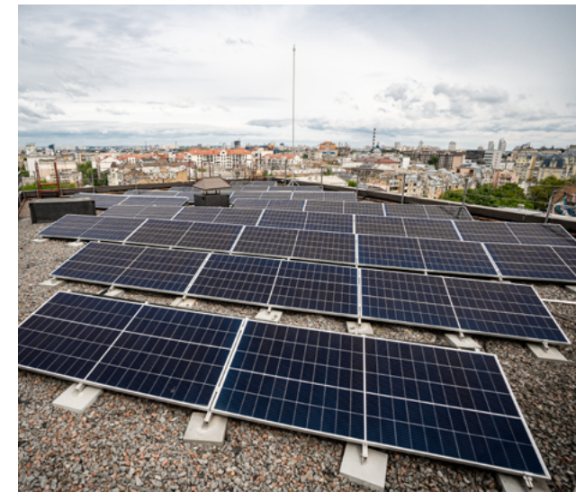
Зображення 28 – Фотоелектричні панелі на будівлі Мінфіну
