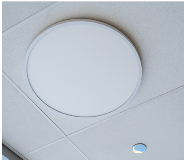
Зображення 13 – Встановлені LED-світильники у будівлі Мінфіну
