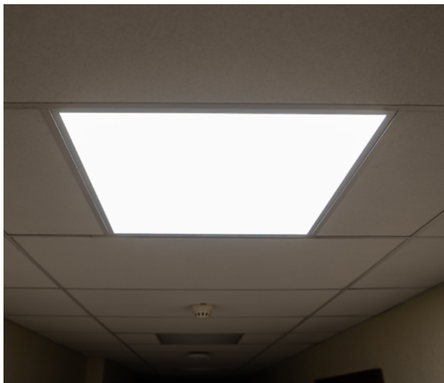
Зображення 12 – Встановлені LED-світильники у будівлі Мінфіну
