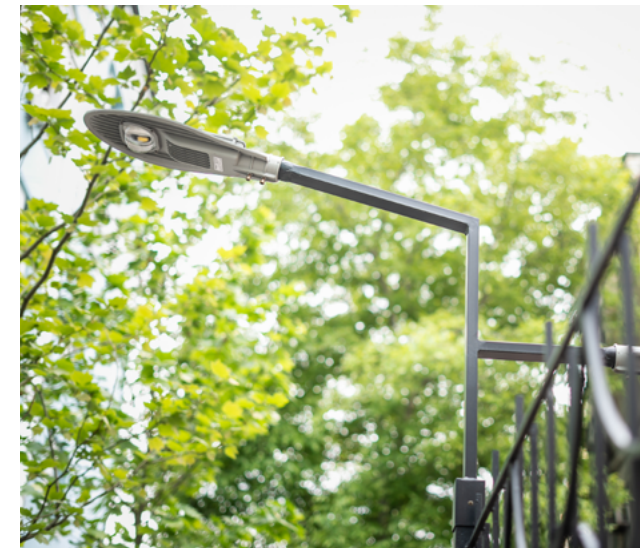
Зображення 14 – Встановлені двонаправлені LED-світильники на огорожі Мінфіну
