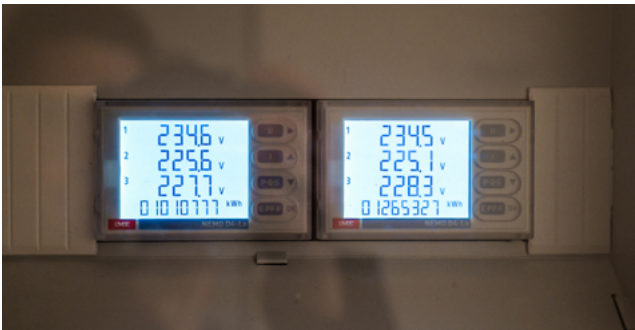
Зображення 21 – Прилади для обліку електроенергії та аналізу якісних характеристик електромережі
