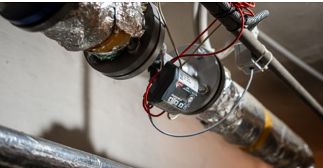
Зображення 20 – Змонтовані лічильники теплової енергії
